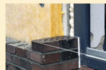
Bild 5: An allen Kontaktflächen zwischen den beiden Schalen sind ausreichend dicke Dämmstreifen entsprechend der DIN 4108 Bbl 2 einzulegen.
