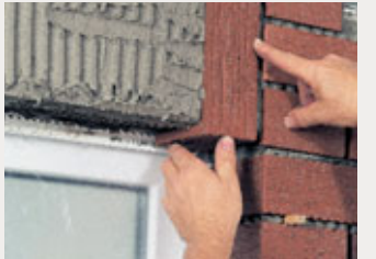
Bild 2: Mit Winkelriemchen für die Stürze wird das beabsichtigte Bild einer gemauerten Wand vermittelt.
