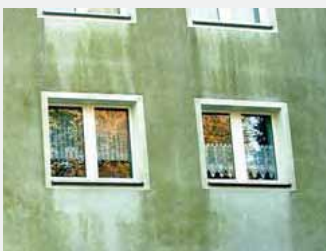
Fassaden aus WDVS sind für energieeffiziente Gebäude in Norddeutschland (wie z. B. Passivhäuser) wegen der akuten Gefahr der Algenbildung nicht zu empfehlen.
