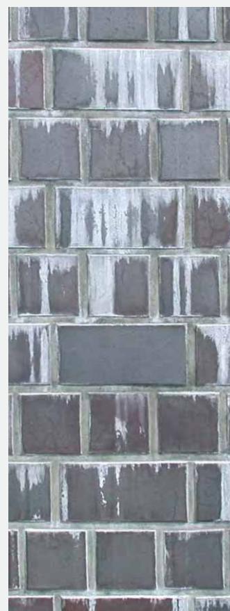
Kalkauslaugungen als Folge mangelhafter nachträglicher Verfugung.
